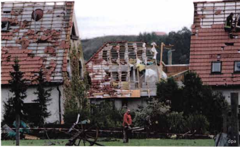
Abb. 12 Im thüringischen Quirla richtete ein Tornado am 2. Oktober 2006 erhebliche Schäden an.
